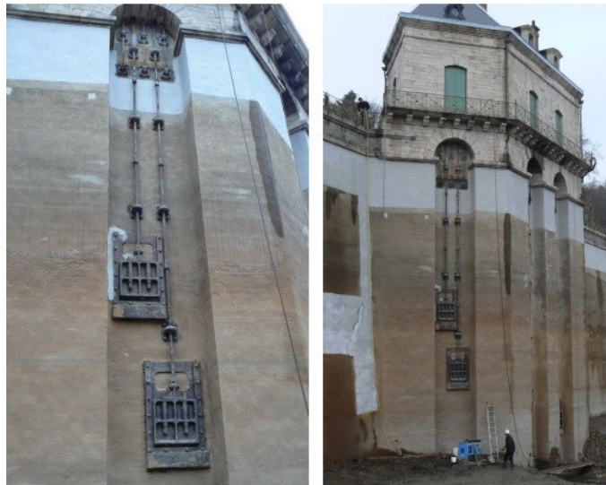
Tour de prise (Photos DDT 58 - Vidange 2008)
