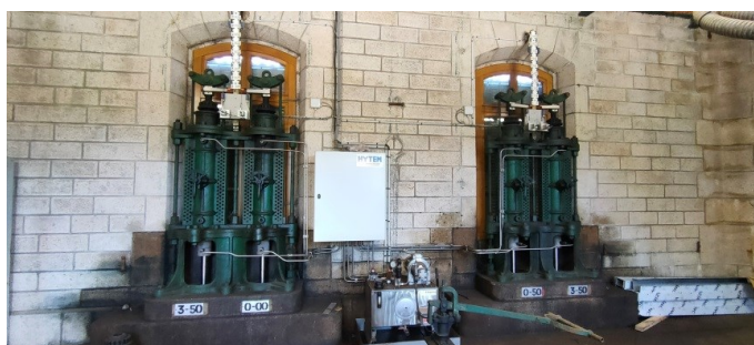
La salle des machines
