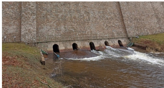
Epanchoir n°1 (Photo DDT 58)
