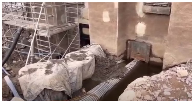
...et débouché d'une des buses d'évacuation
