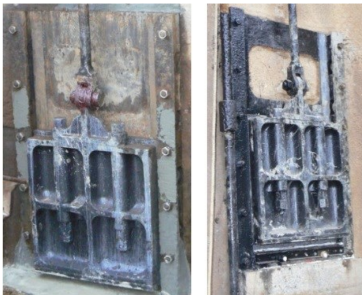
Epanchoir n°1 - vannes 0,00 et 3,50 m (Photos DDT 58 - Vidange 2008)
