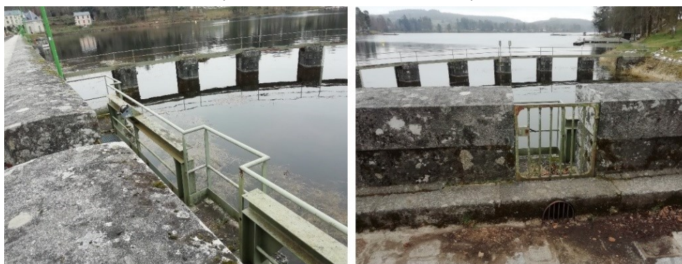
Garde-corps, passerelles et portillon de l'EVC au droit de la crête
