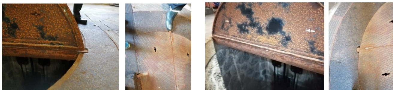
Plaques et IPE des puits de la chambre à vanne (Photos DDT 58 et EGIS)
